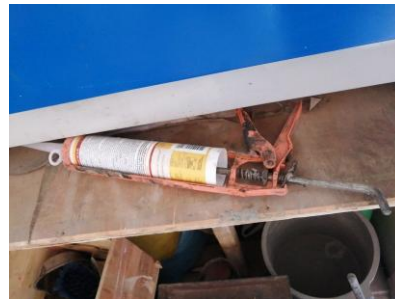
Figura 84: Silicona utilizada para sellar las filtraciones. Fuente: Propia.
