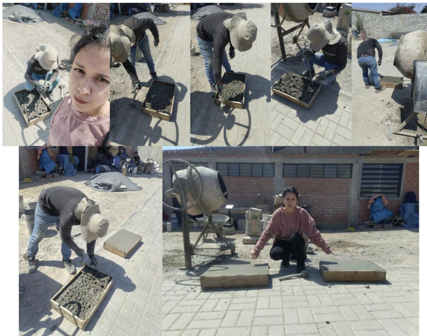
Figura 102: Proceso de vaciado de los moldes en el porcentaje de 1.5% de adición de fibra de acero entrefilado.
