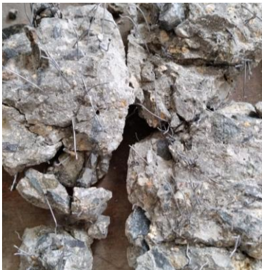
Figura 73: Proceso de rotura para 2%. Fuente: Propia.
