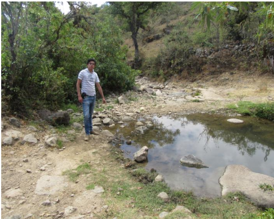
Fotografía. 4. Esguerrimiento superficial que afectan el camino en estudio.
