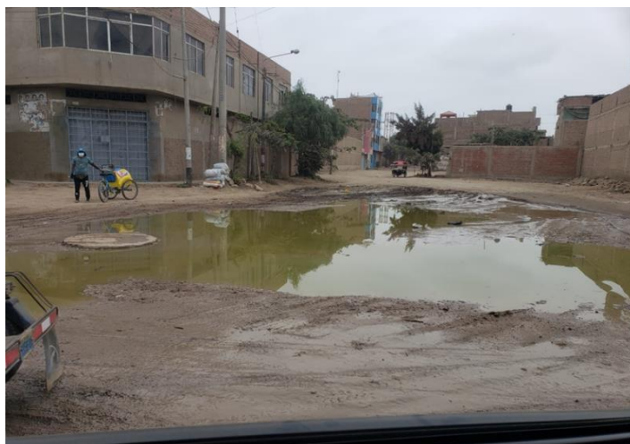
Figura 13 Presencia de agua empozada
