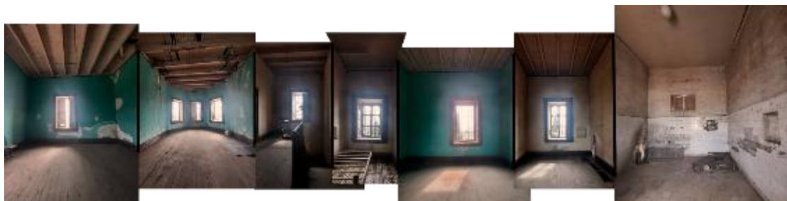
Figura 8: Estado actual del cuadrante 4-5 A
