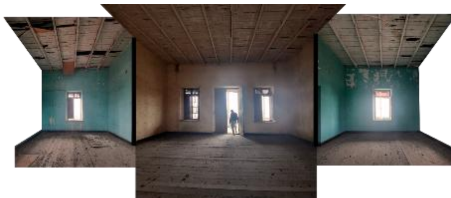
Figura 9: Estado actual del cuadrante 1-2 A
