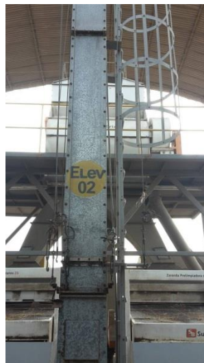
Ilustración 15: Elevador de cangilones
