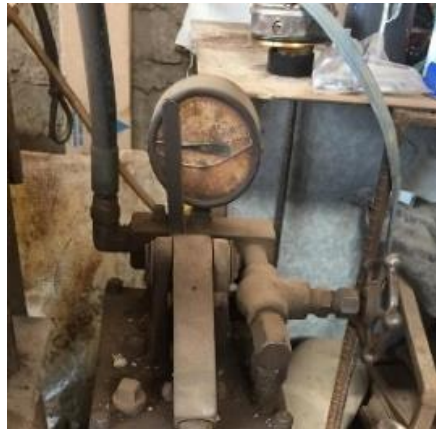
Figura N°: 17 Válvula de prueba [Ferretería la gata]
