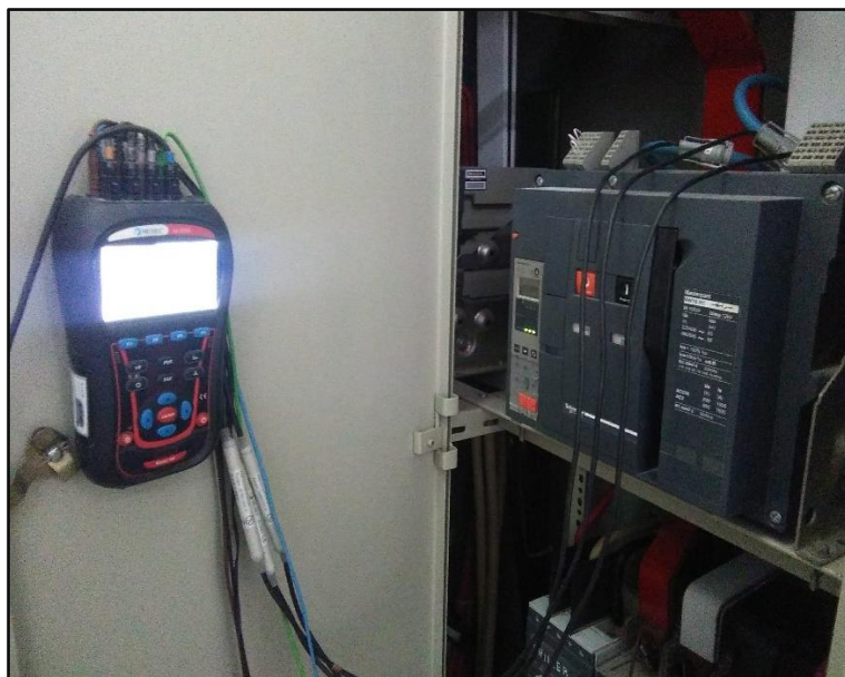
Figura N° 60. Registro de datos por parte del analizador de redes Metrel en la Sub estación "C" de la planta industrial "El Águila S.R.L"
