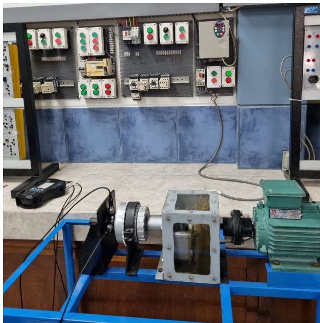
Figura A.6: Motor conectado al variador Altivar 31 en el Laboratorio de Automatización y Control, USAT
