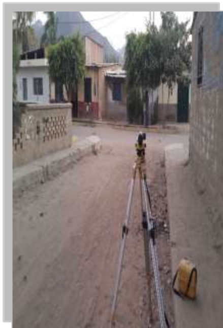
Fotografía N° 15 : Estado situacional de la calle la Balsa.
