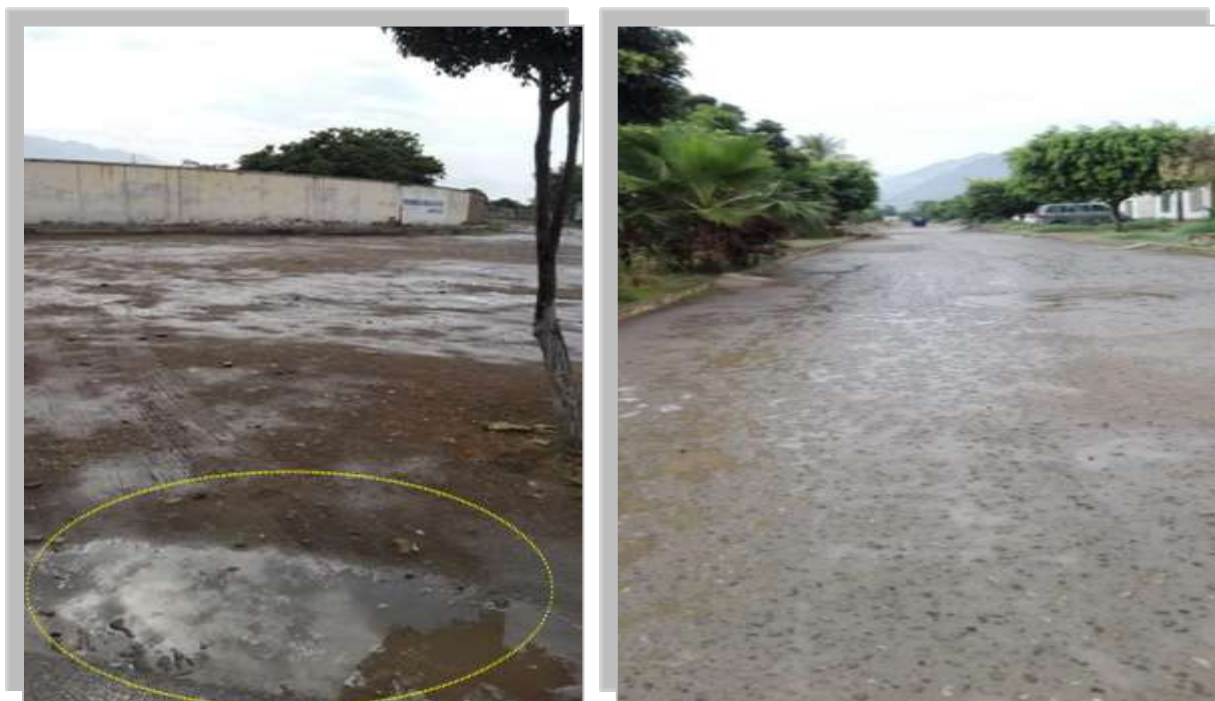
Fotografía N° 6 : Estado situacional de calles durante las lluvias, 2018
