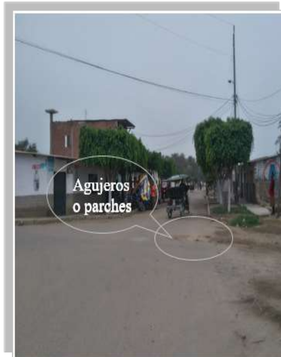
Fotografía N° 12 : Estado situacional del pavimento de la calle Real.
