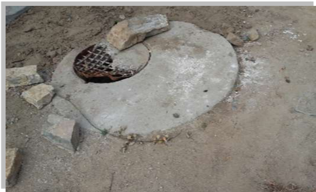
Fotografía N° 2 : Daños ocasionado en colectores, marzo 2017
