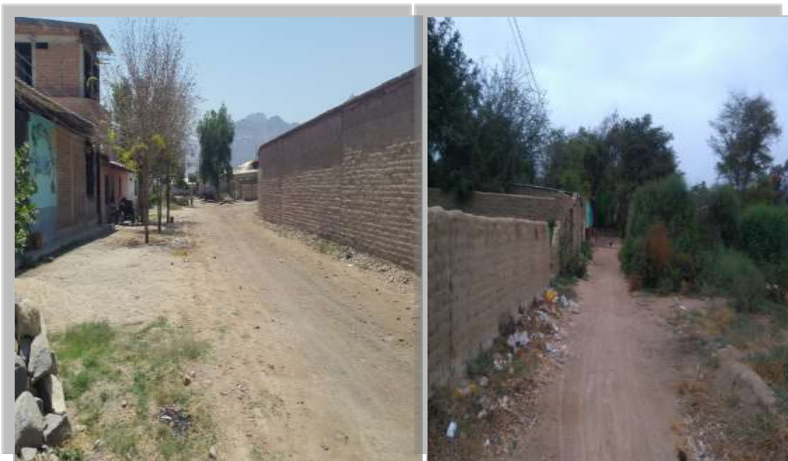
Fotografía N° 11 : Estado situacional de la calles San Juan.
