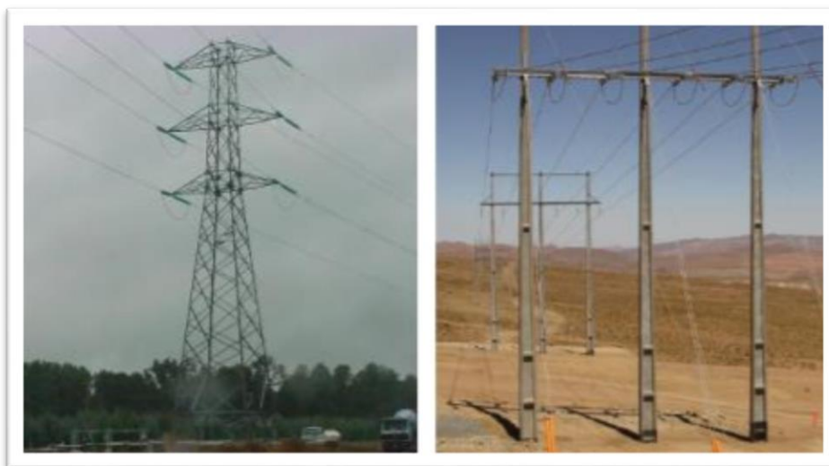
Figura 17. Estructuras de anclaje de líneas de transmisión.
