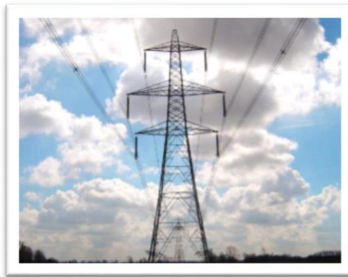
Figura 15. Torres de líneas de transmisión.
