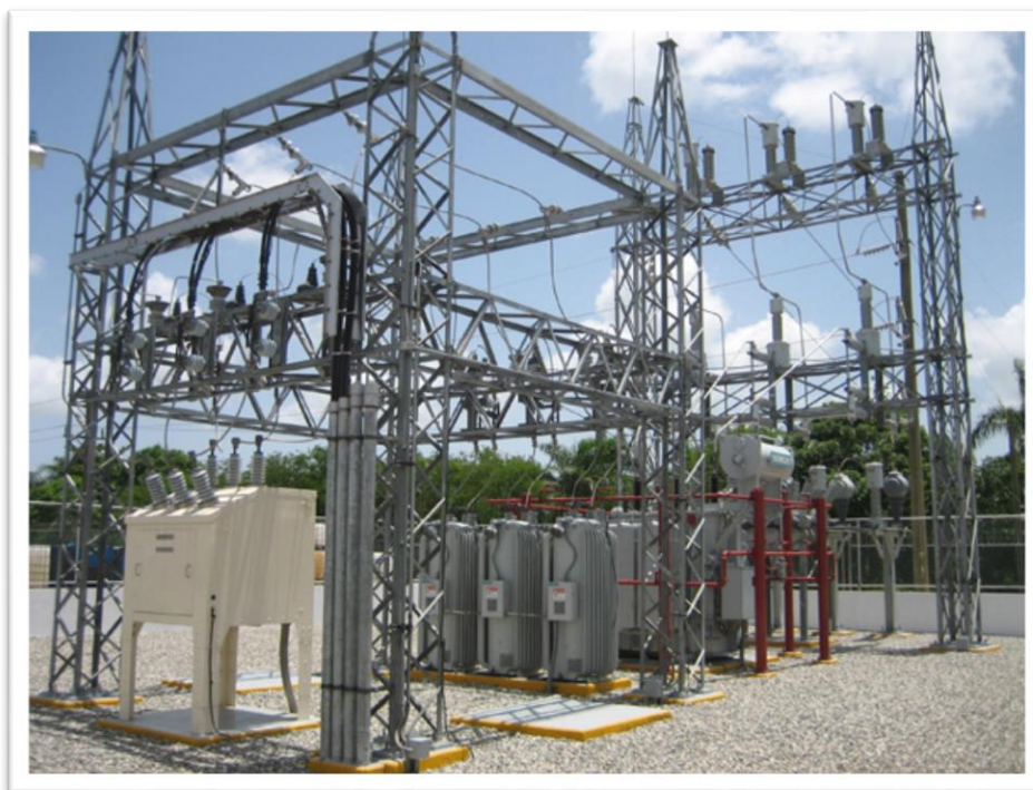
Figura 3. Subestación de transmisión.
