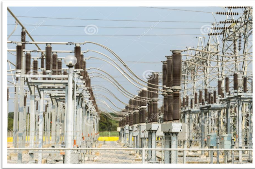
Figura 4. Subestación de distribución.
