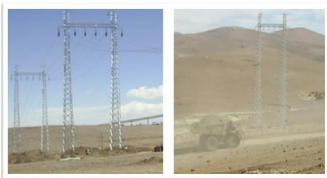
Figura 19. Estructura de abatimiento de conductores.
