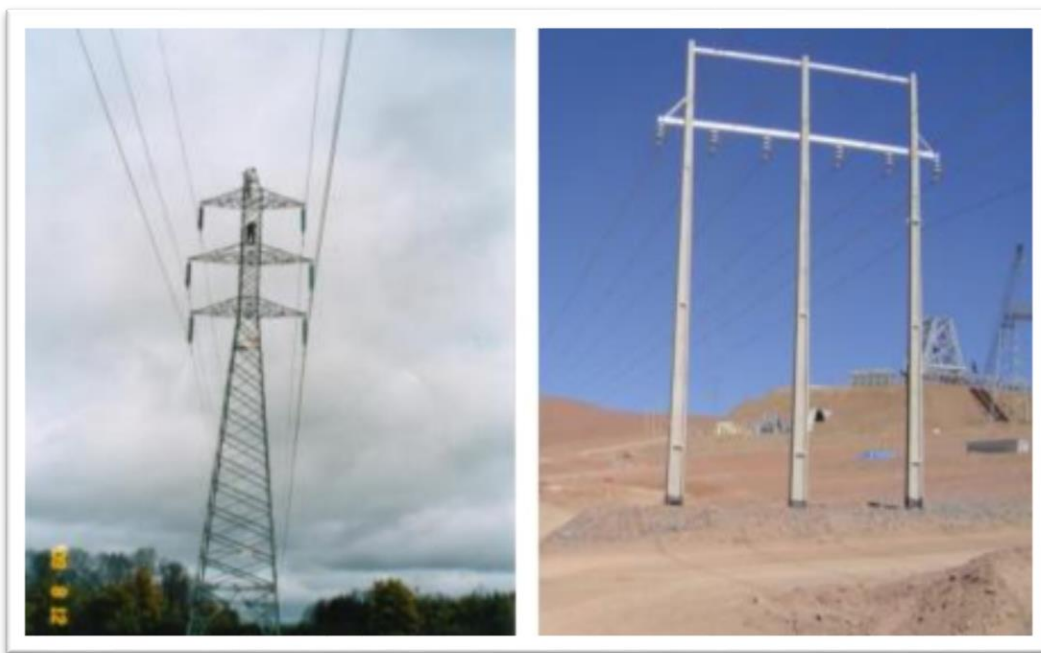
Figura 16. Estructuras de suspensión línea 2x220 kV y línea 2x23kV respectivamente.
