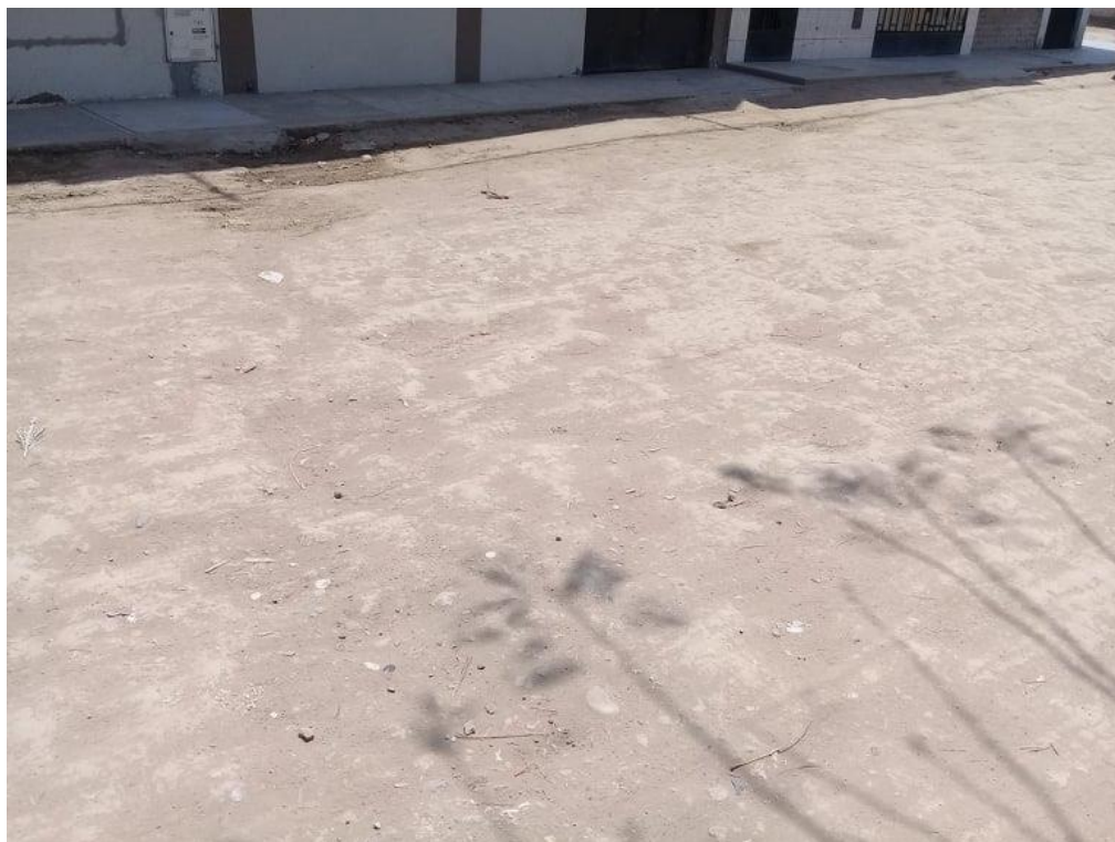
Suelo de zona en estudio con notorios hundimientos.
