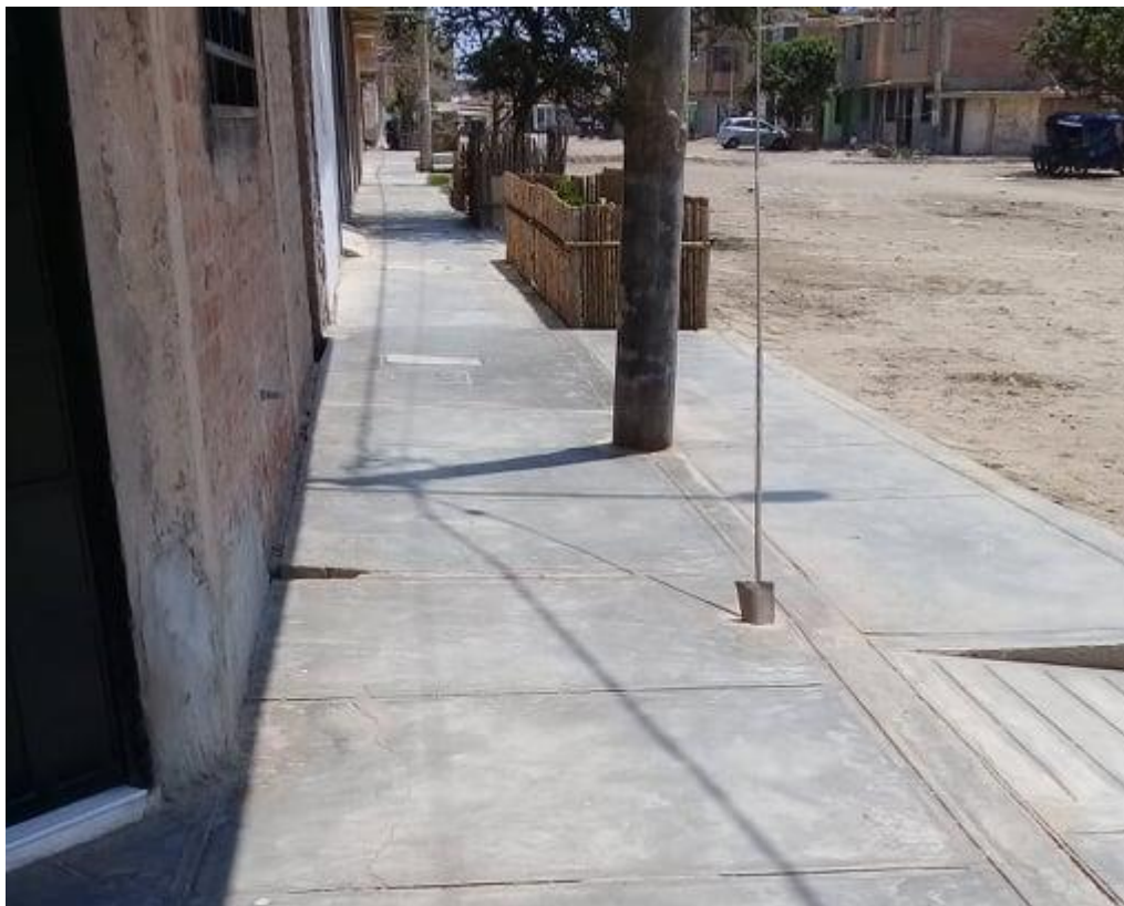
Zona en estudio con evidentes problemas de veredas con asentamientos.
