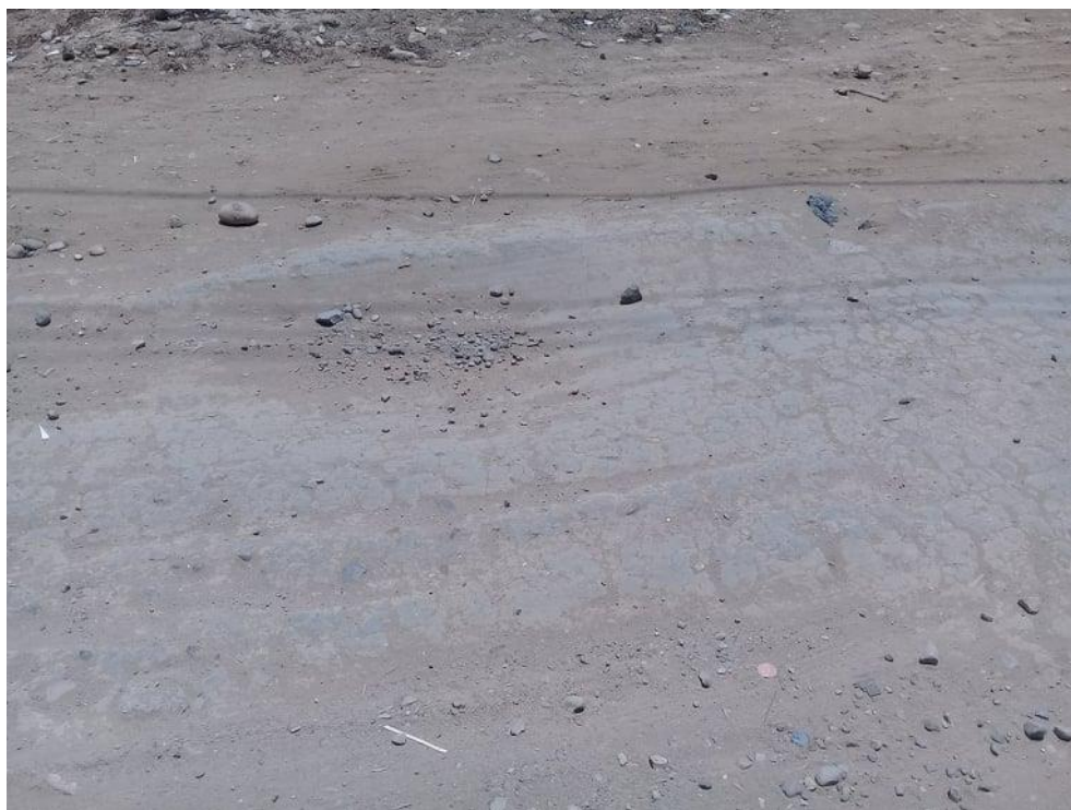
Hundimientos en vía no pavimentada de zona en estudio
