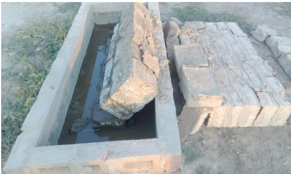
Fig. 161: Derrumbe del Muro de adobe con adición del 10%
