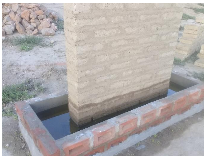
Fig. 158: Fotografía del Muro de 10% tomada el 29/05/2019
