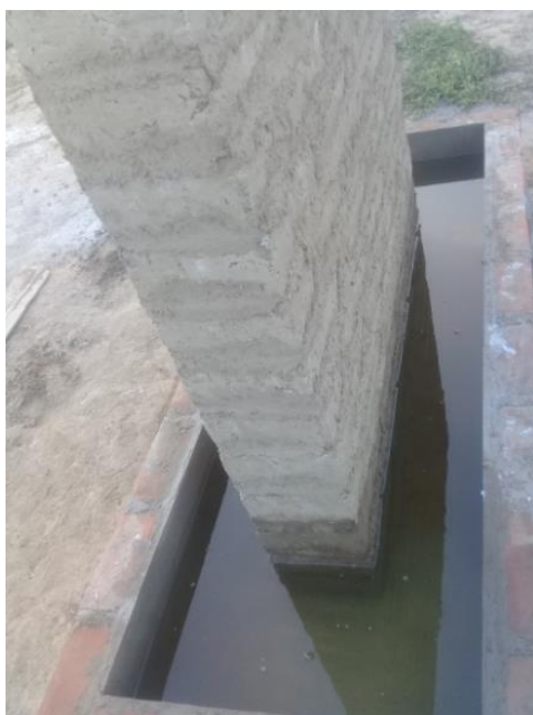
Fig. 124: Muro de Adobe después de ocurrido el sismo
