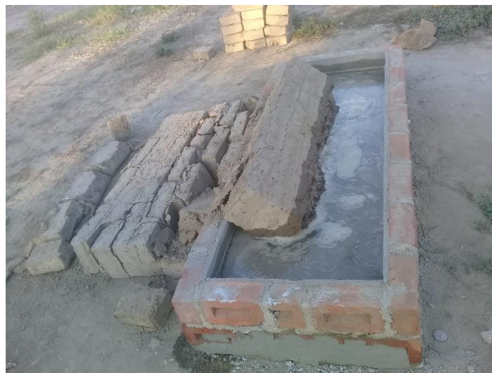
Fig. 146: Fotografía del derrumbe del Muro Patrón
