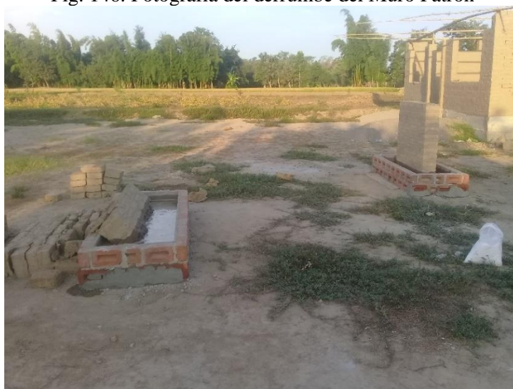
Fig. 147: Fotografía de ambos muros después del derrumbe Obteniéndose los datos de capilaridad siguientes:
