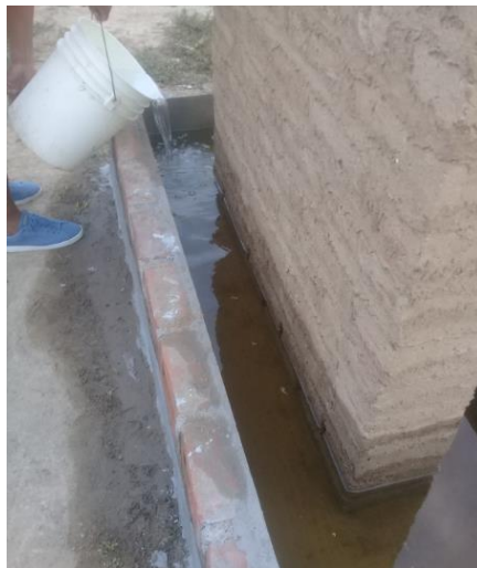
Fig. 123: Vertido de volumen de agua absorbido
