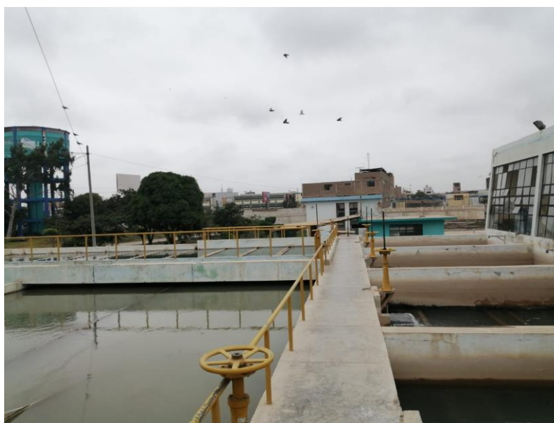
Figura 9: Planta de tratamiento de agua Chiclayo
