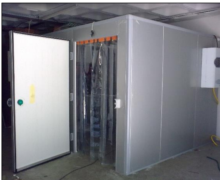
Figura 6. Cuarto frío de congelación – Cámara
