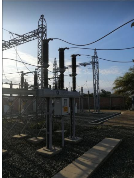
Ilustración 7 Interruptor de la subestación de potencia Cayalti
