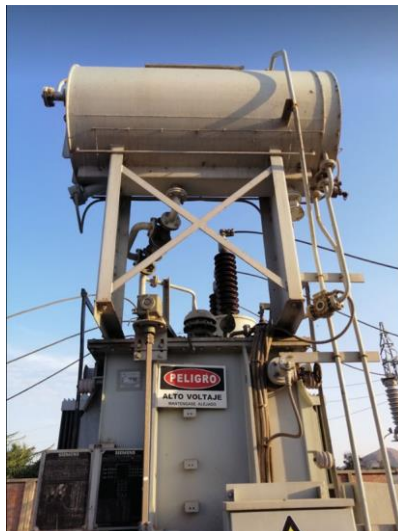
Ilustración 8 Transformador de potencia del Alimentador CAY-201
