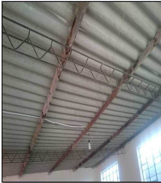
Instalaciones Eléctricas expuestas
