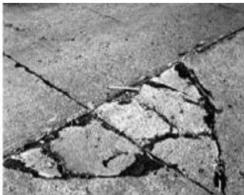
Ilustración 4: Fallas estructurales en pavimentos
