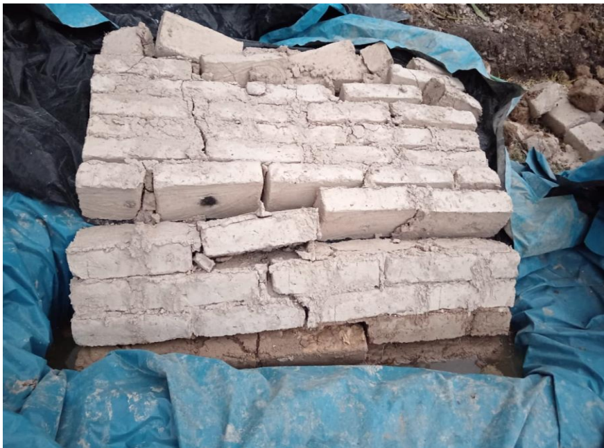
Ilustración 53: Desplome del muro de bloque de tierra estabilizada al 5 % de cemento
