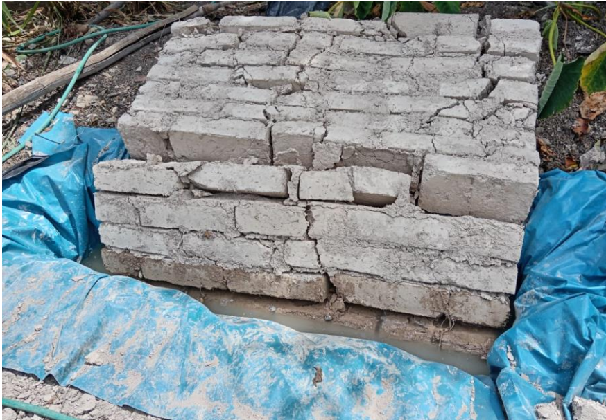
Ilustración 52: Desplome del muro de bloque de tierra estabilizada con 3% de cemento
