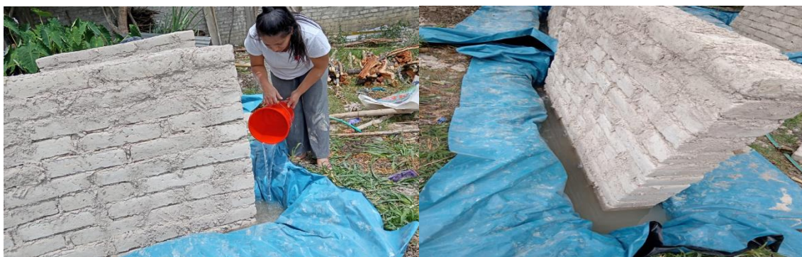
Ilustración 49: Inundación de los muros
