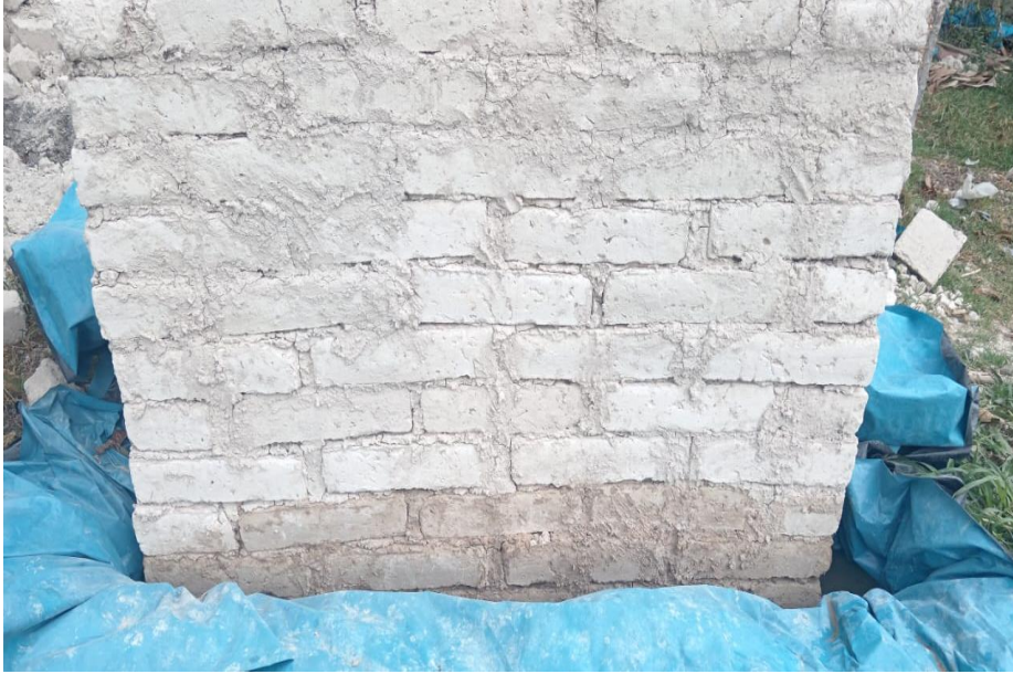
Ilustración 54: Capilaridad y absorción del muro con 8% de cemento
