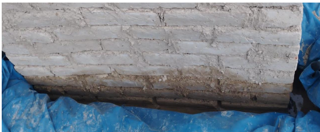
Ilustración 59: Inundación – desgaste de la junta
