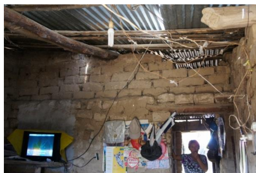
Fig 69: Foto conexiones precarias de alumbrado. Fuente: Toma propia.
