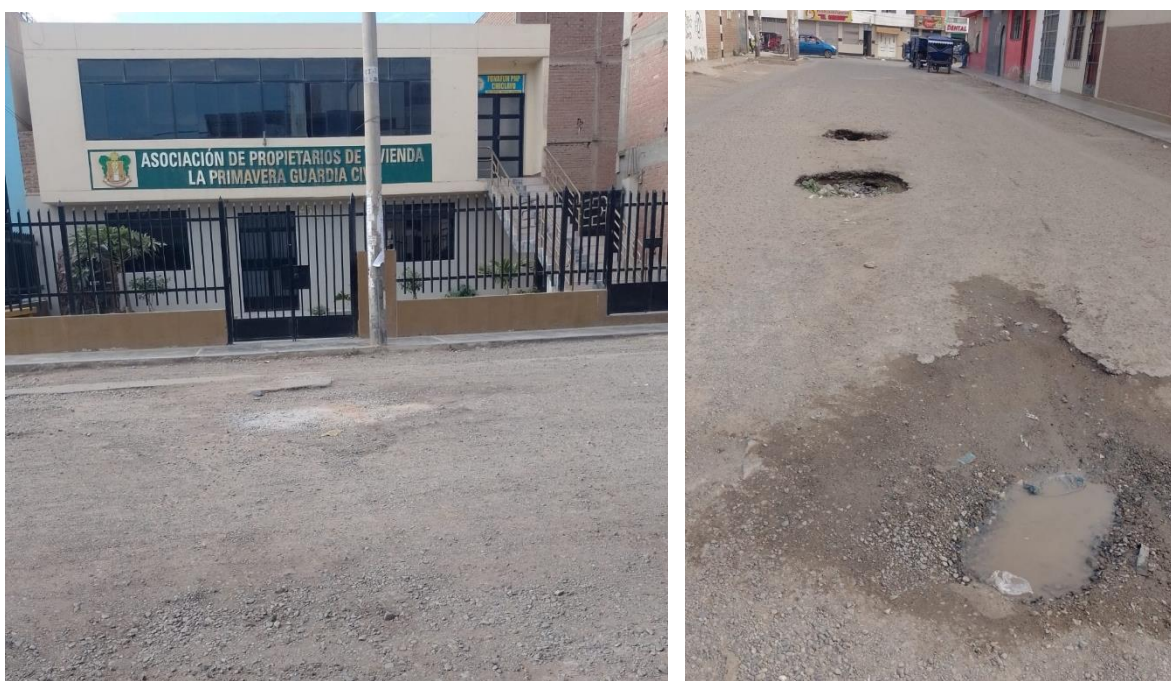
Ilustración 26. Pavimento en estado crítico en Av. Wilfredo Valdiviezo y calle Cusco.
