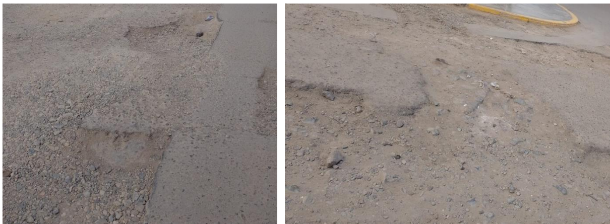
Ilustración 27. Pavimento en estado crítico en Calles Wilder Rodríguez Reyes y Eduardo Ordoñez.
