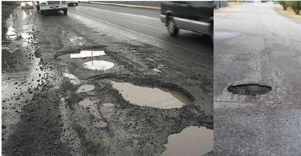
Figura 1. Bacheo profundo saturado y bacheo superficial.
