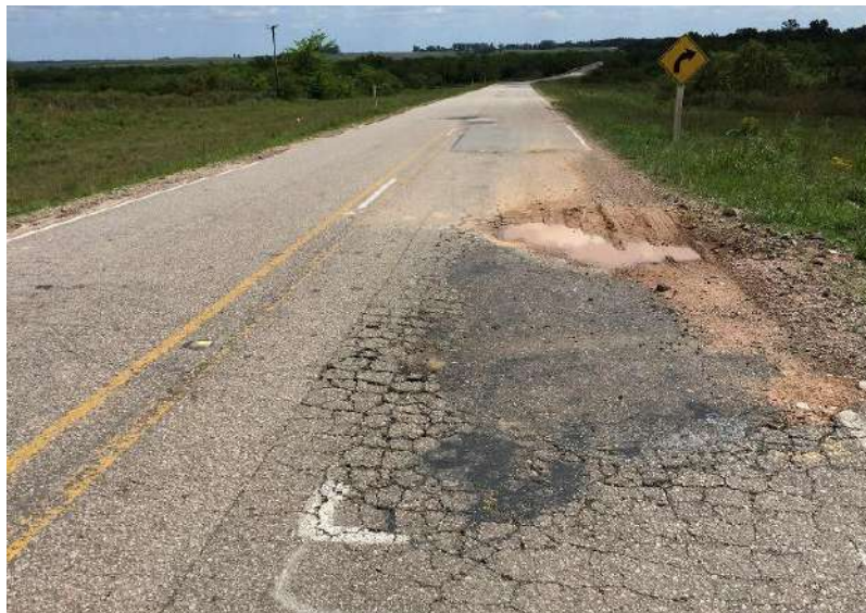
Figura 2. Falla por piel de cocodrilo y bacheo profundo por napa freática.
