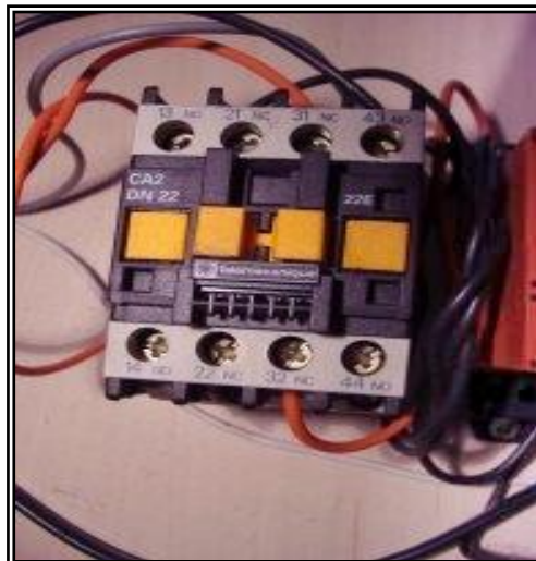
Figura 2.5: Contactores LC1D10 de 220 voltios
