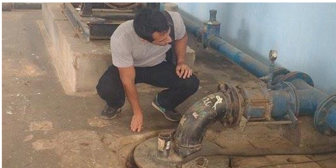
Figura N° 130. Visita al Pozo Tubular
