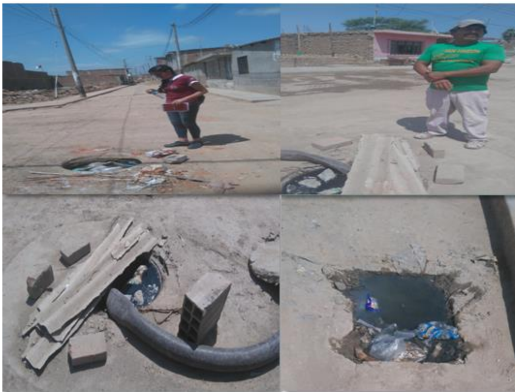
Figura N° 133. Buzones Colmatados en la Parte Baja de la Zona Urbana (calle La Victoria y Libertad), Durante el Fenómeno Costero.
