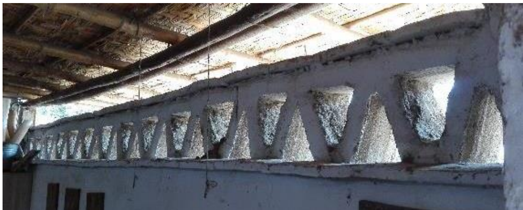
Ilustración 9 Taller 3: Cerramiento del ambiente de exhibición, confección y venta. Fuente: Ficha fotográfica N°3
