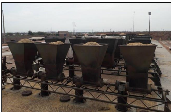
Figura 21. Quemadores de combustible
