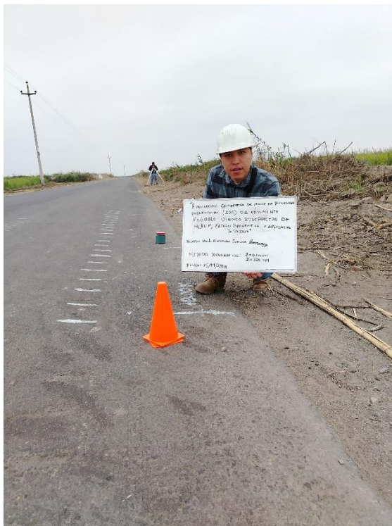
Fig. 29. Punto de inicio de la toma de datos en la progresiva km 2+000.
