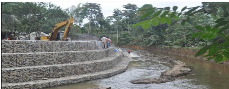
Figura 20 Muros de gaviones frente a derrumbes de suelo residual Fuente: El comercio
