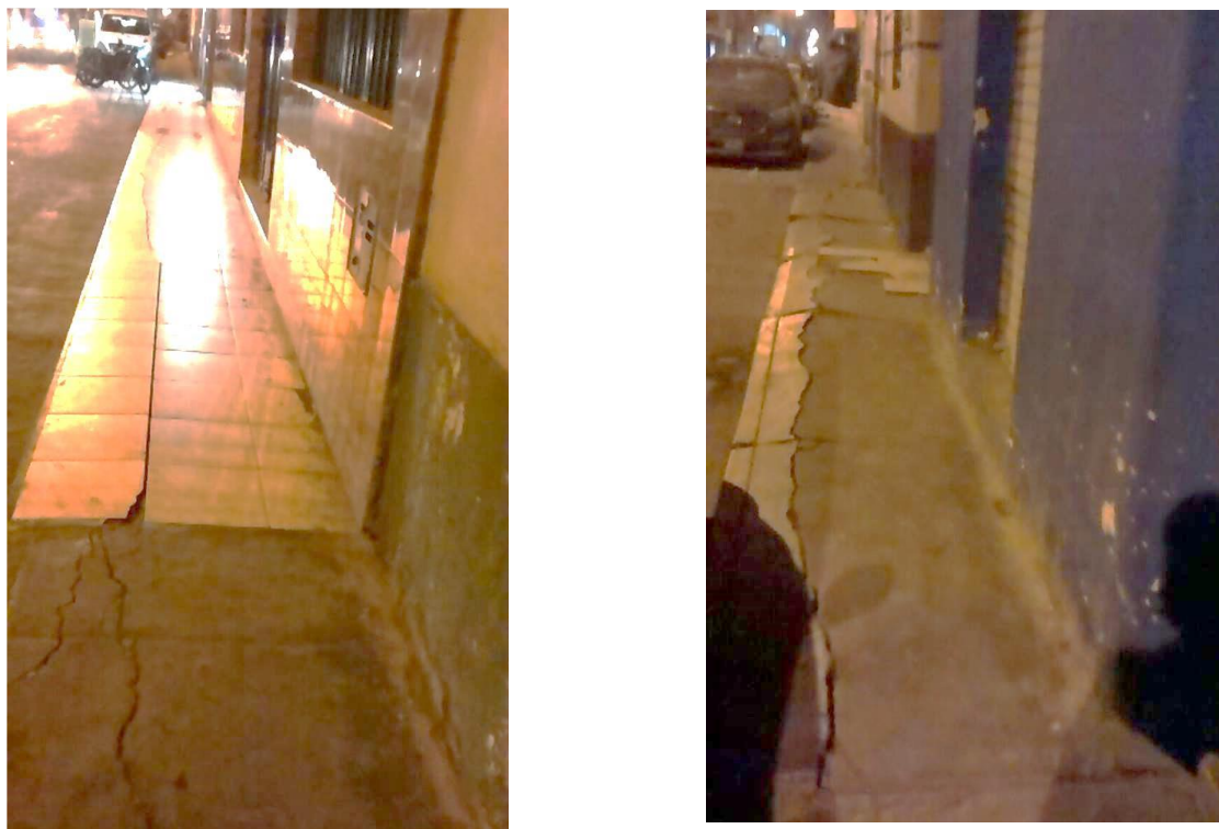
FIGURA N°22: Problemática de grietas en veredas
