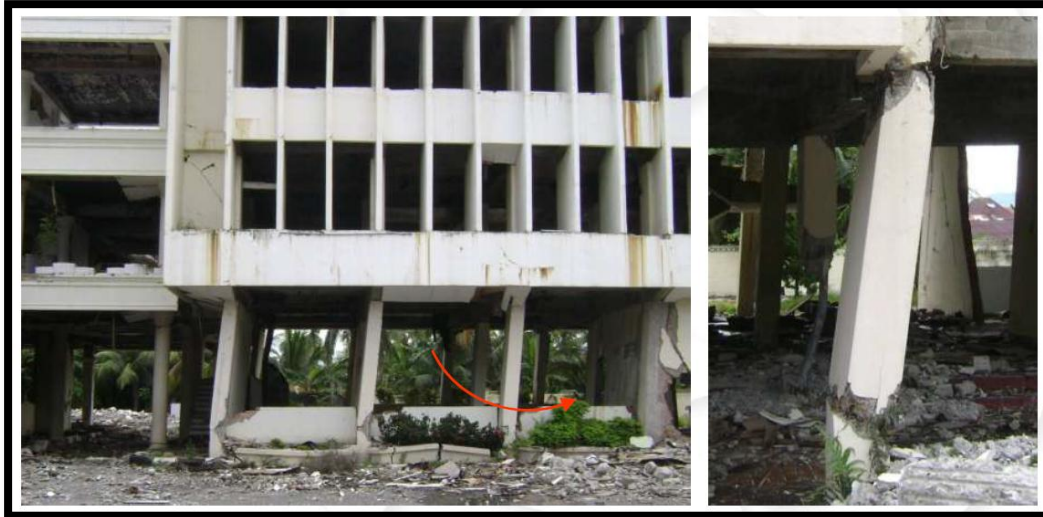
Imagen N° 161 Articulaciones plásticas en la estructura.
