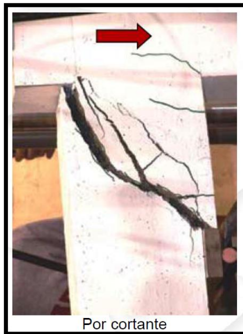
Imagen N° 159 Falla por corte en columnas.
