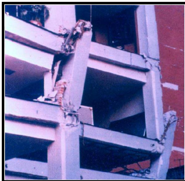
Imagen N° 160 Falla en las conexiones entre la viga y la columna.
