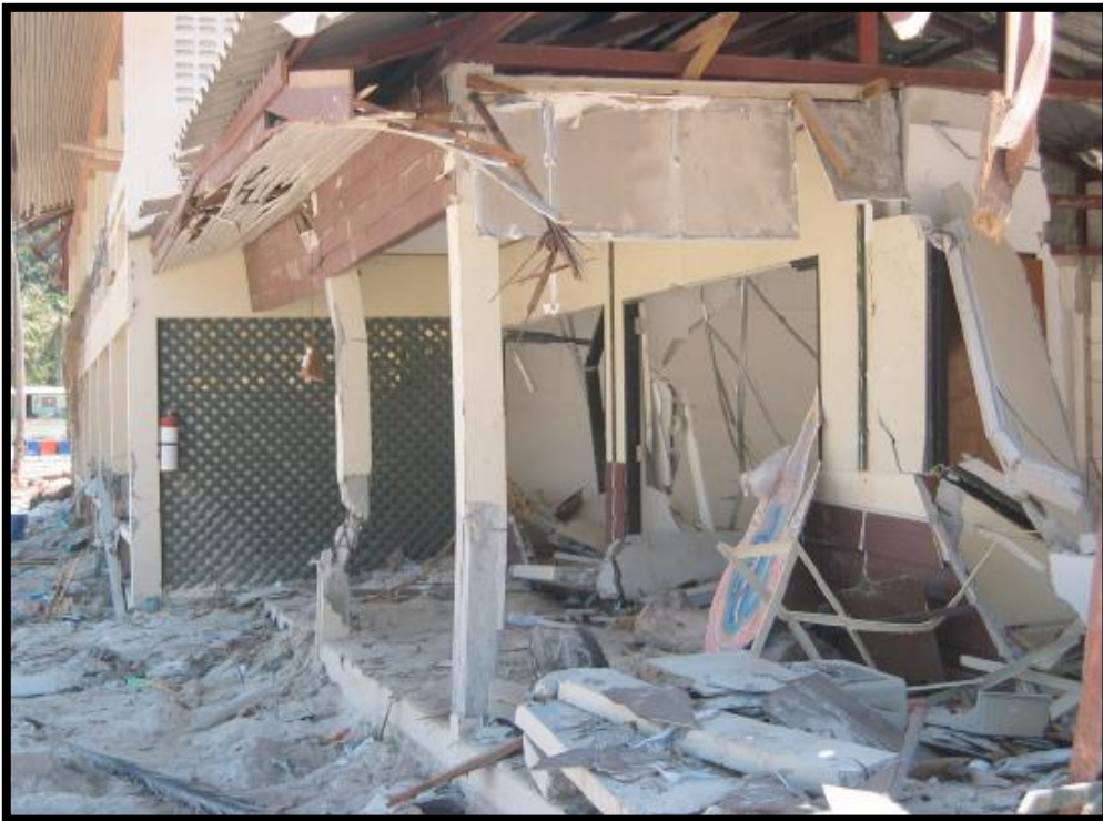
Imagen N° 146 Columnas de concreto dañadas por el impacto de escombros.
