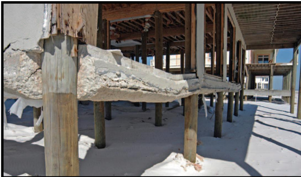
Imagen N° 137 Erosión del suelo del edificio. (Huracán Iván, 2004).
