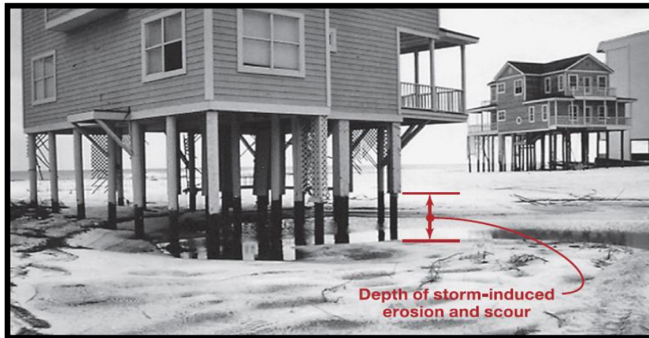
Imagen N° 134 Casa apoyada por pilares en la zona de flujo canalizado
