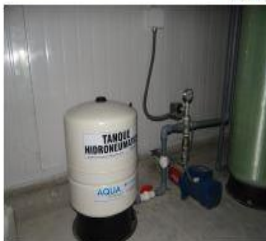
Bomba con tanque hidroneumático y accesorios completos
