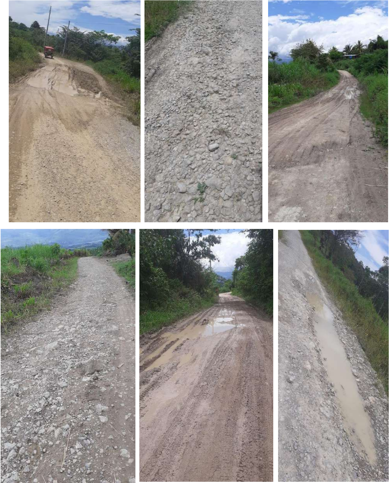
Figura 16 Estado actual de la carretera
