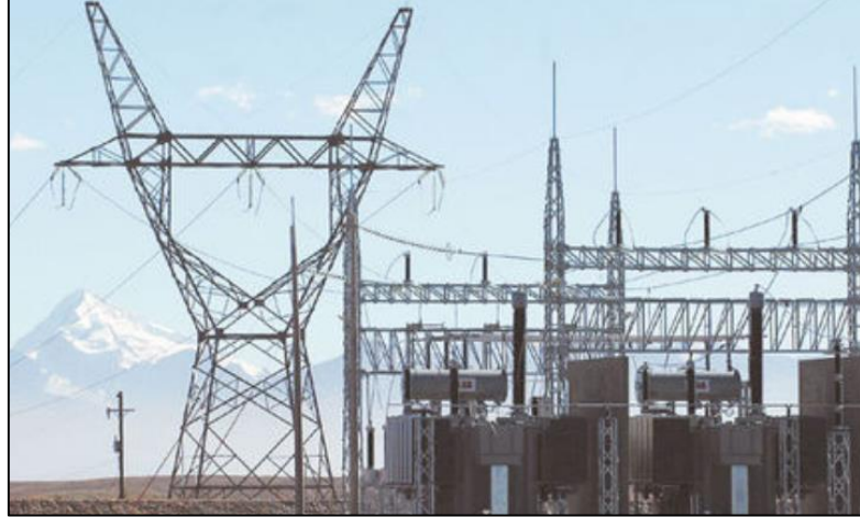
Figura N° 39: Torre de remate de una línea de transmisión
