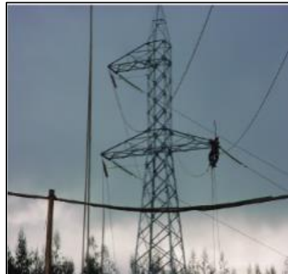
Figura N° 12: Estructuras de simple circuito de 220 kV
