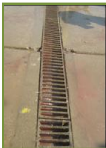
Figura N° 18: Canales para el transporte de las aguas residuales
