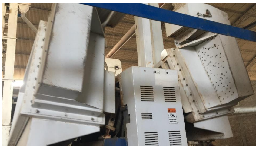
Figura N° 14. Rotura de Planchas Internas
