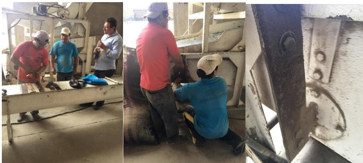
Figura N° 10. Rotura del tensor
