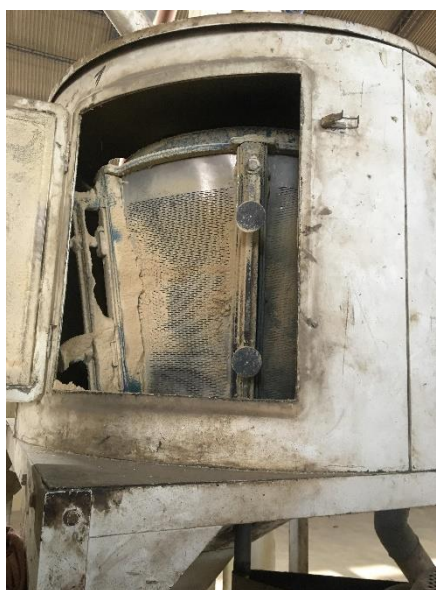
Figura N° 20. Descentrado del Tambor
