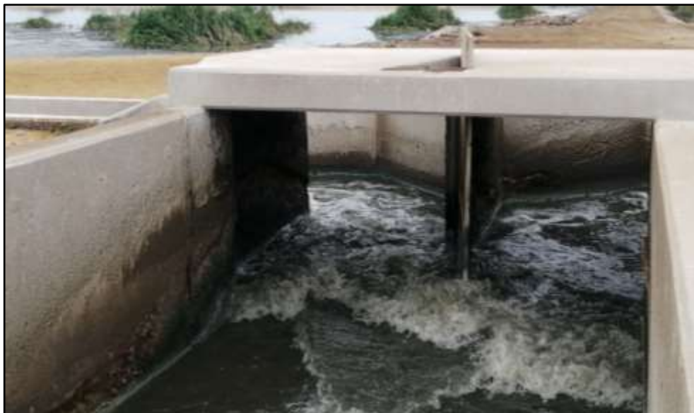
Figura 13: Caja de distribución de Caudales. Fuente: Elaboración propia
