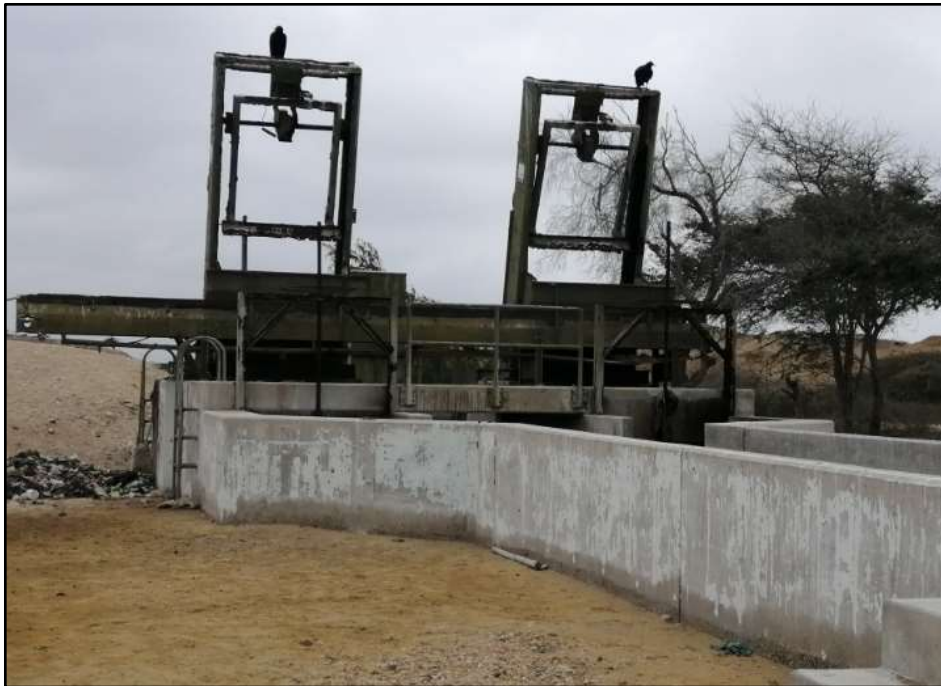
Figura 11: Cámara de Rejas
