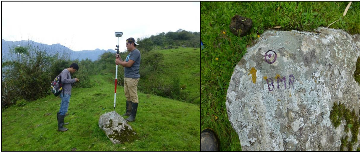
Fotografía N° 13: Paso N°4.- Establecemos un BM de referencia para poder hacer replanteo para su posterior ejecución.
