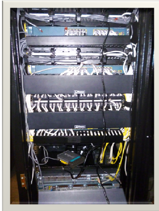
Figura N° 21: Imagen del gabinete de los equipos de comunicación Planta Norte
