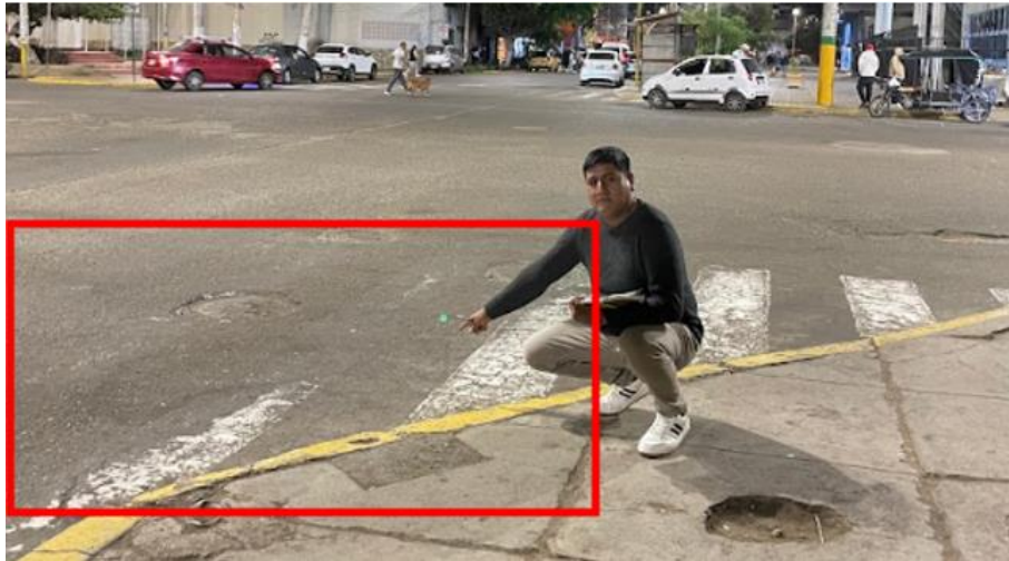
FIG. 90: SEÑALANDO LA FALTA DE SEÑALIZACIÓN HORIZONTAL (PASE PEATONAL)
