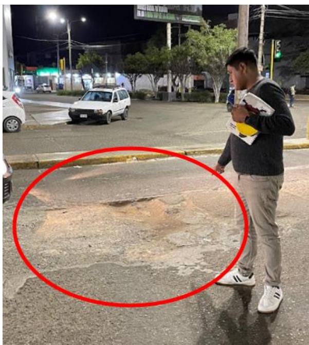
FIG. 89: MAL ESTADO DE LA CAPA ASFÁLTICA - AVENIDA SALAVERRY
