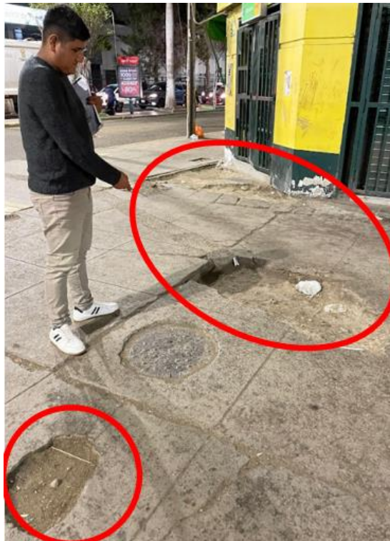
FIG. 91: OBSERVANDO EL MAL ESTADO DE LAS VEREDAS
