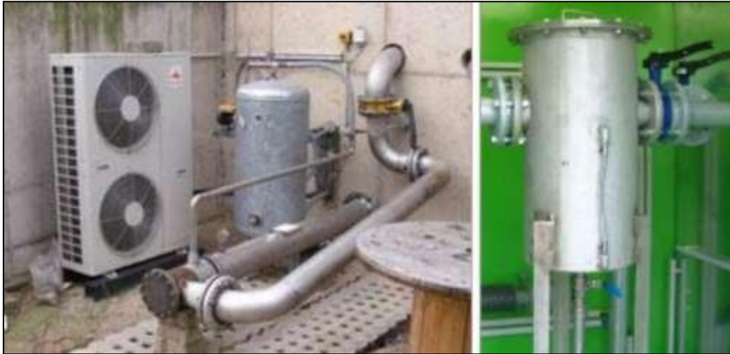
Figura 16: Reductores de humedad y condensados.
