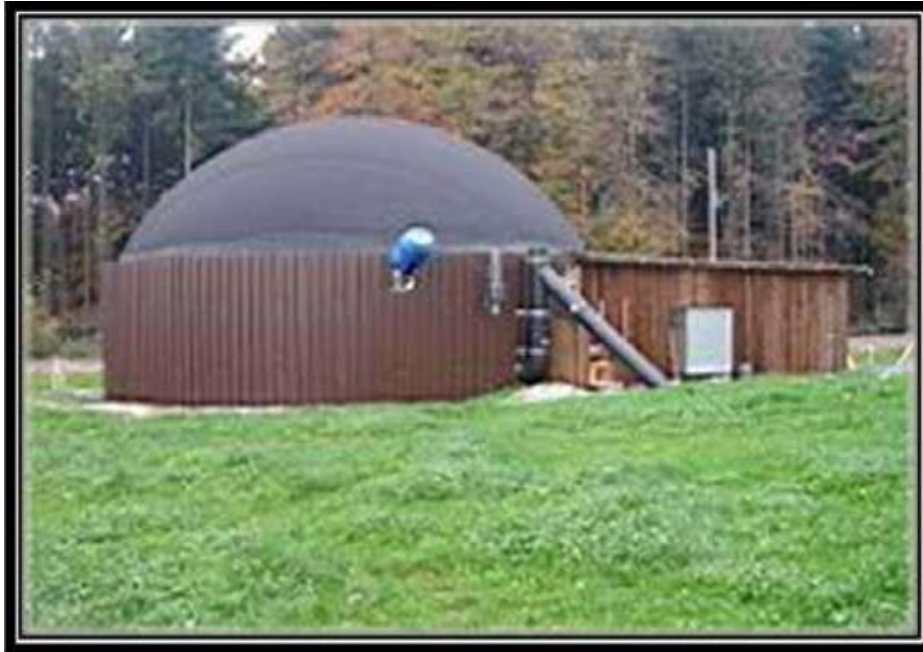
Figura 8: Digestor con tanque de almacenamiento tradicional y cúpula de polietileno.
