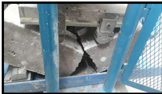
Figura N° 56: Falla por flexión
