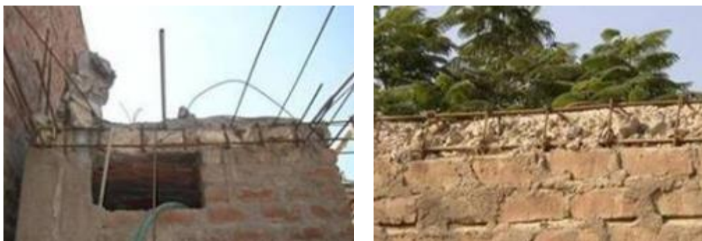
Fig. 2 Juntas mal ubicadas
