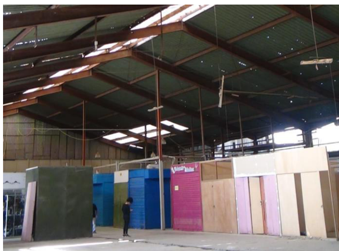
Figura 35: Vista interior del edificio – Puestos en abandono. Fuente: Elaboración propia
