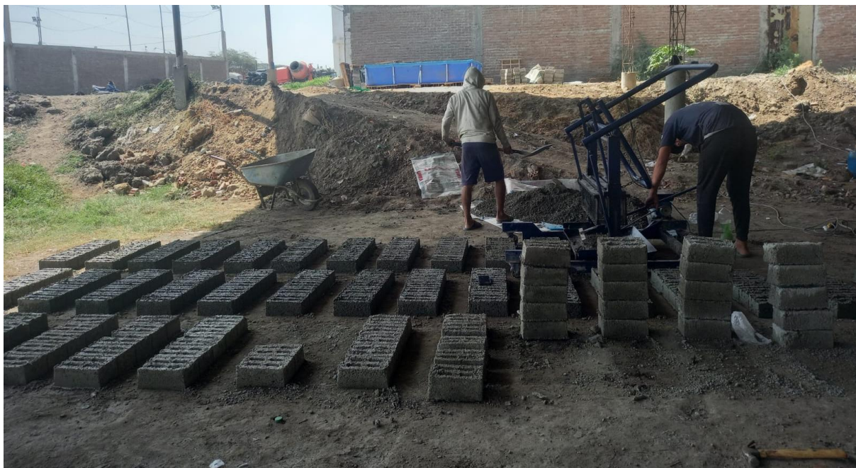
Ilustración 20 Elaboración de los ladrillos propuestos en el lugar de piso de tierra.
