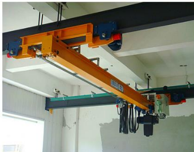
Figura 21. Puente Grúa Monorraiel
