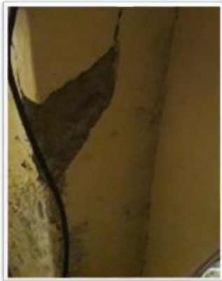
Grietas en columna
