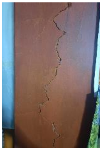
Fisura en columna
