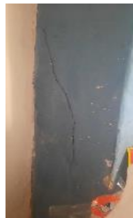
Fisura en columna
