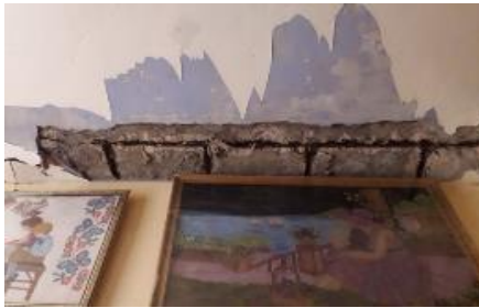
Acero de losa expuesto
