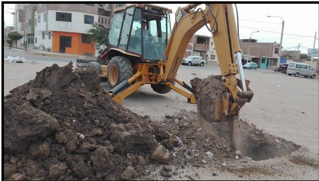
Imagen N° 44 Uso de la retroexcavadora en la excavación de la calicata para alcanzar la profundidad de exploración
