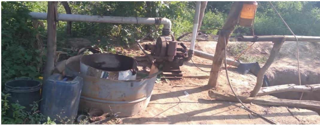
Figura 19. Sistemas de bombeo que utilizan actualmente
