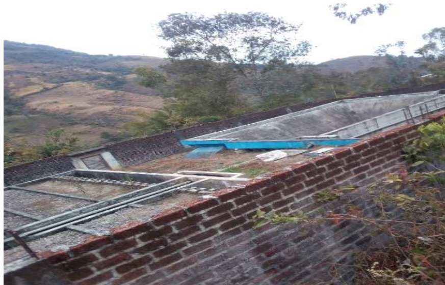
Imagen N°16 : Planta de Tratamiento
