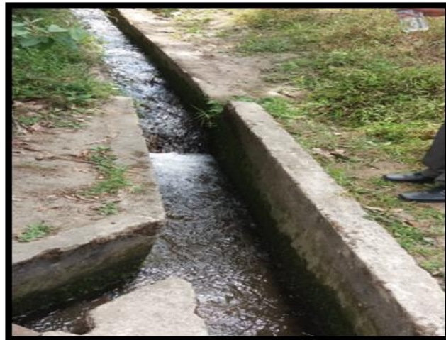
Imagen N° 24: Canal donde desembocan las aguas Residuales
