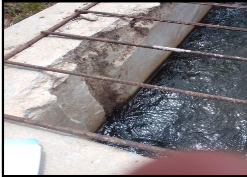
Imagen N°18 : Daños en la camara de reposo
