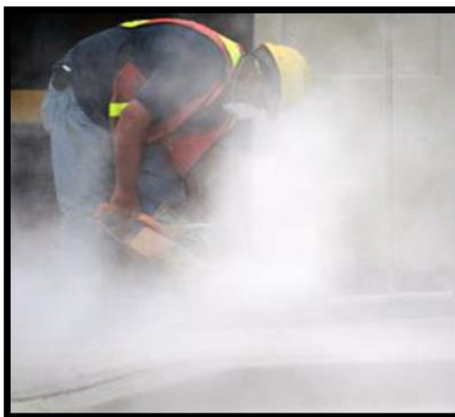
Imagen N°03 :Polvo generado en obra
