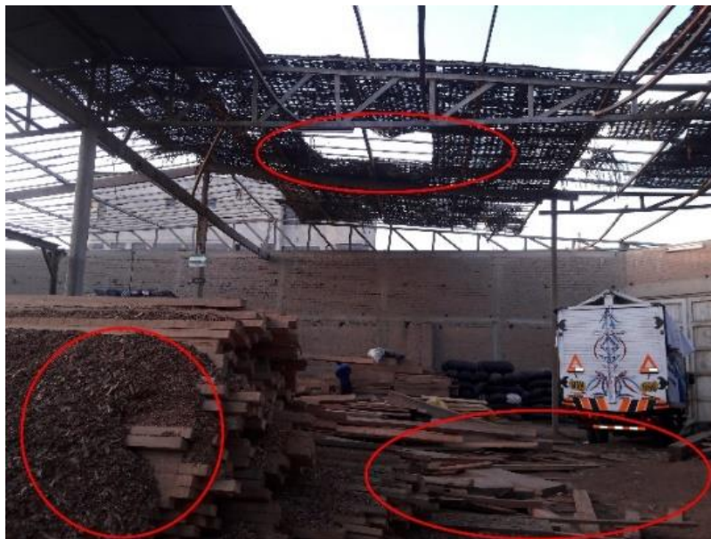
Figura 39. Desorden y acumulación de residuos en distintas áreas de la planta. Fuente: Empresa.
