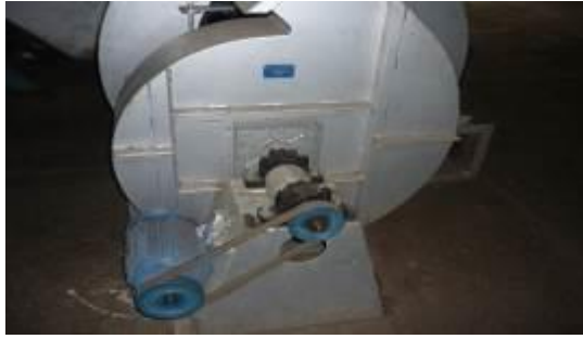
Figura 14 Ventilador de tiro inducido
